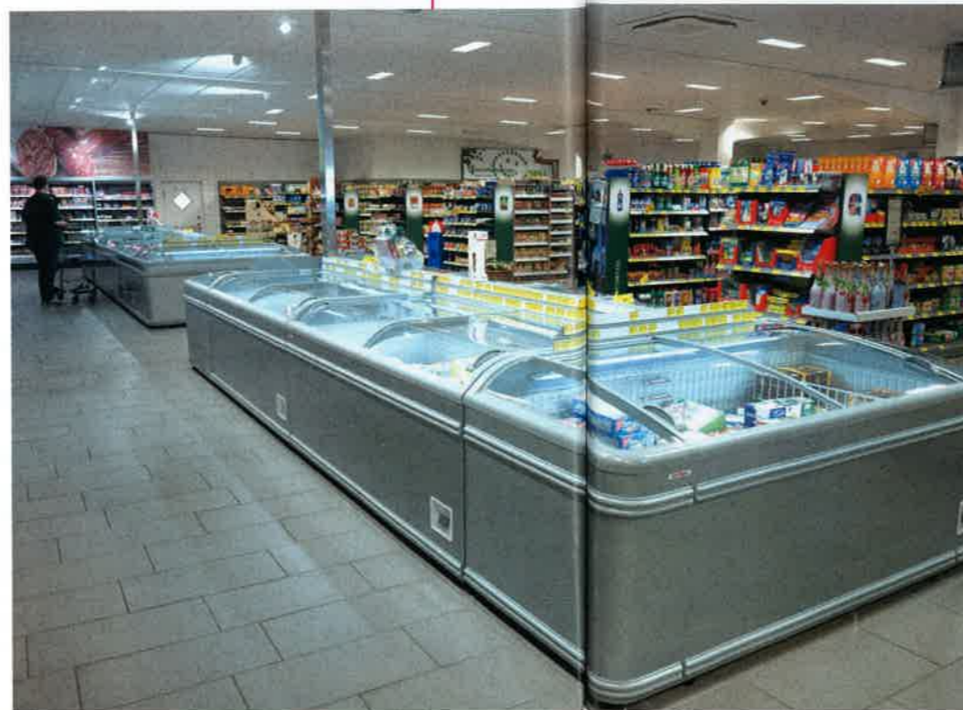
E Geräumig: die TK-Abteilung. An den Regalgondeln sorgen Bilder für zusätzliche Orientierung.
